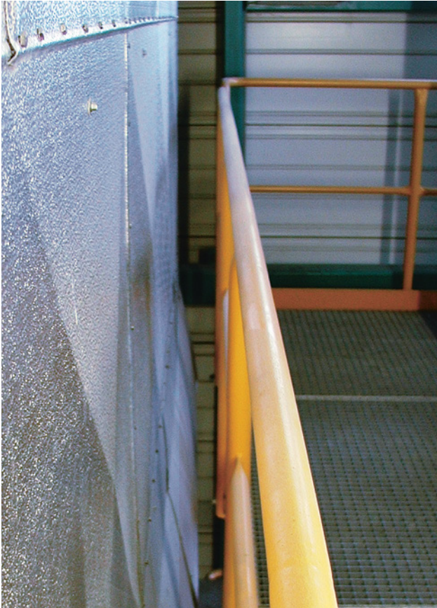
7 Geländer zur Sicherung der maschinen- bzw. wandseitigen Absturzkante. Das Geländer ist erforderlich, weil der Abstand der Laufebene zur seitlichen Maschinenverkleidung bzw. zur Wand mehr als 180 mm beträgt.
