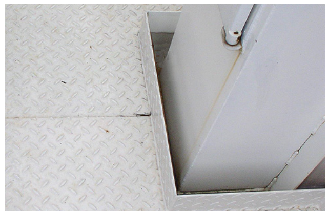
9 Fussleiste um eine Bodenöffnung, deren horizontaler Abstand zur Säule mehr als 20 mm beträgt.
