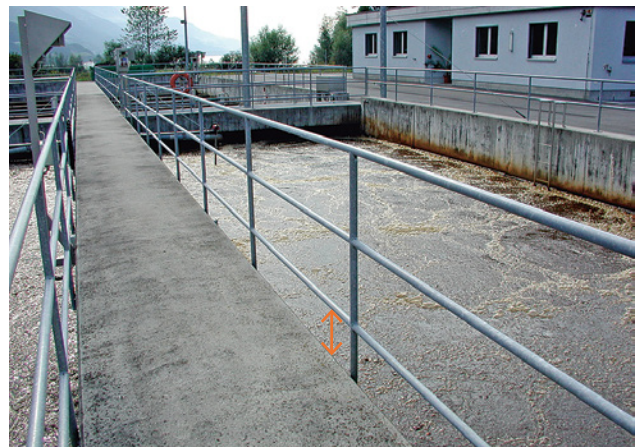
22 Aus betrieblichen Gründen (Schneeräumung) wurde an diesem Laufsteg in einer Kläranlage keine Fussleiste angebracht. Sie wurde durch eine zusätzliche Knieleiste ersetzt. In diesem Fall darf der Abstand zwischen der Lauffebene und der untersten Knieleiste nicht mehr als 300mm betragen.
