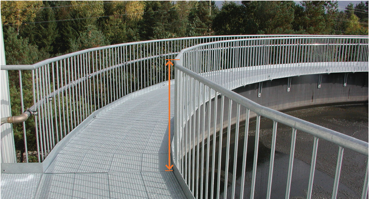
10 Die Geländerhöhe beträgt 1,10m – von der Lafebene zur Oberkante des Handlaufs gemessen.
