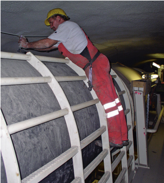
12 Arbeiten über ein Geländer hinweg. Die Gestaltung des Geländers, insbesondere dessen Höhe, entsprechen den besonderen sicherheitstechnischen und betrieblichen Erfordernissen.
