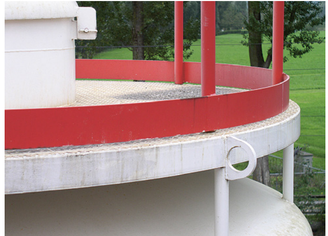
21 Durch den Freiraum zwischen Lauffebene und Fussleiste kann Regen- und Schmelzwasser abfließen. Der Freiraum beträgt nicht mehr als 12mm.
