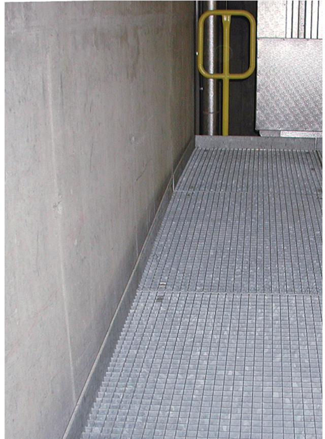
8 Fussleiste zur Sicherung der maschinen- bzw. wandseitigen Absturzkante. Die Fussleiste ist erforderlich, weil der horizontale Abstand der Laufebene zur Wand bzw. zur Maschinenverkleidung mehr als 20 mm beträgt. Im Bereich des Hintergrunds, wo der Abstand 180 mm überschreitet, wurde ein Geländersegment angebracht.
