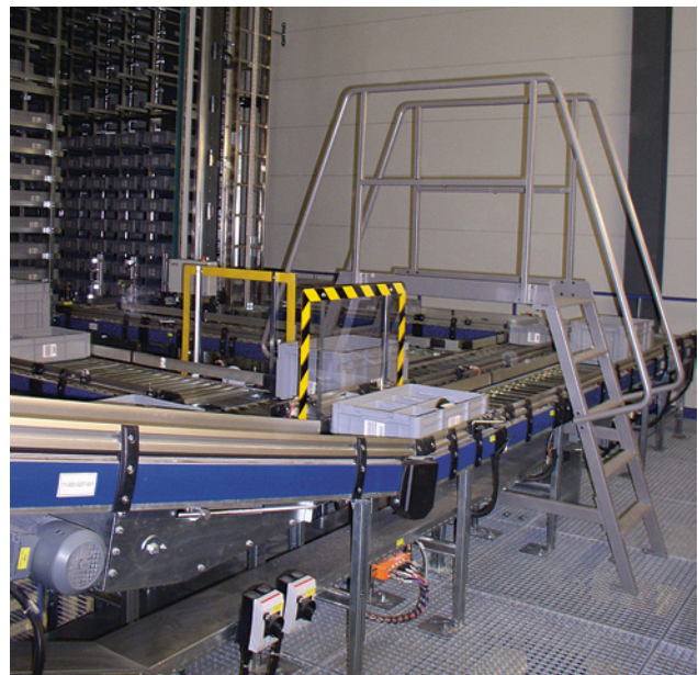
6 Übergangsbrücke mit beidseitigem Geländer. Der Absturz von Personen und Gegenständen auf die automatische Fördereinrichtung wird wirksam verhindert. Die Treppenleitern haben beidseitig einen Handlauf.geringeren Absturzhöhe als 500mm erforderlich sein.
