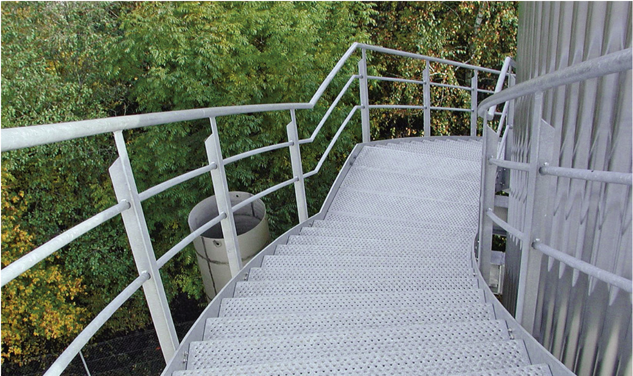
16 Treppengeländer mit zwei Knieleisten. Der Abstand (lichte Weite) zwischen Handlauf und oberer Knieleiste, zwischen den Knieleisten sowie zwischen der unteren Knieleiste und der Treppenwange beträgt nicht mehr als 500mm. Die erforderliche Anzahl an Knieleisten richtet sich nach der Funktion des Geländers.
