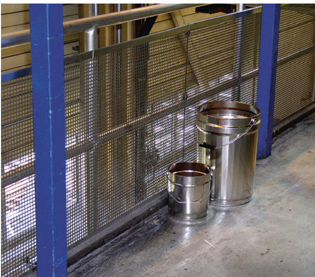
17 Das zusätzlich angebrachte, vollflächige Gitter verhindert wirksam den Absturz von Gegenständen oder Personen.
